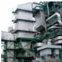
排煙脱硝装置
