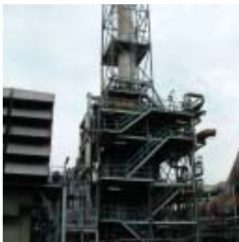
ボイラー廃熱回収装置
