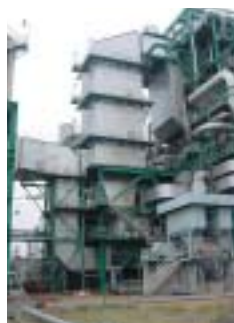
排煙脱硝装置
