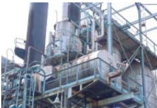
改質装置用廃熱回収装置
