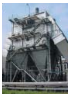
電気集塵装置
