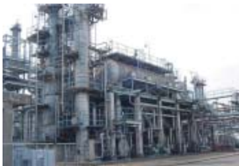
硫黄回収排煙脱硫装置
