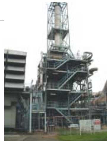
ボイラー廃熱回収装置
