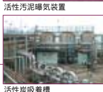
活性炭吸着槽
